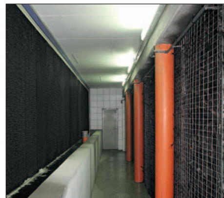
W trzecim poziomie oczyszczania, który składa się z kory, odbywa się biologiczne przetwarzanie nieprzyjemnych zapachów.
