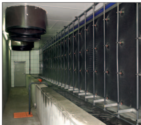
Grupy dysz rozpylają wodę na przednią stronę ściany filtrującej, co zapobiega osadzaniu się kurzu.
